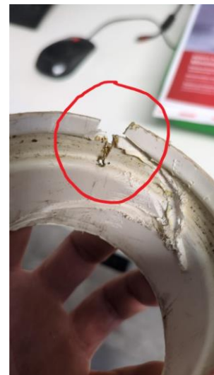
Kuva 6 Vanha muhvi irrotettuna, tiivisteen urassa halkeama. (Muut jäljet sekä puuttuva pala aiheutuneet muhvin irroitukselta.)
