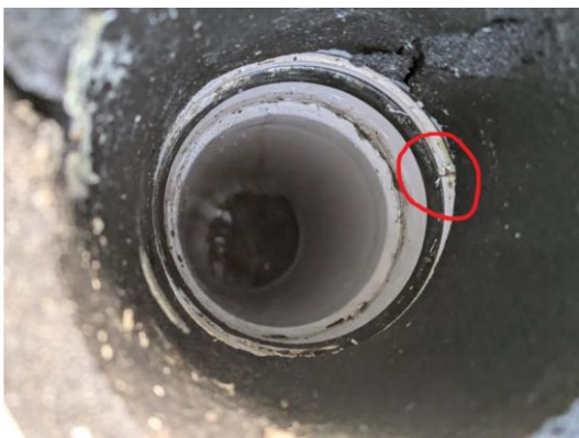
Kuva 1 Vanha kaivon liitos kaivon irrotuksen jälkeen. Kuvassa ympyröitynä halkeama muhvilla.
