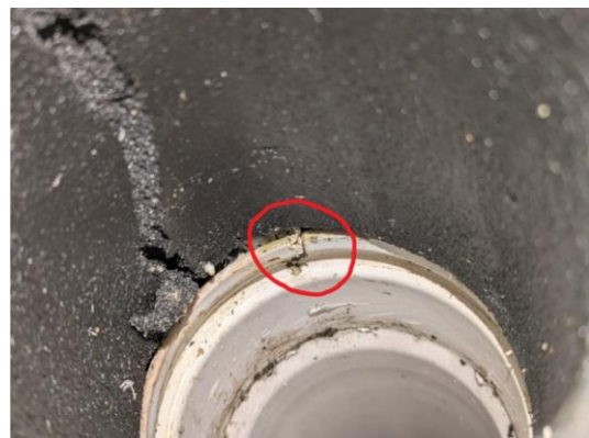
Kuva 2 Vanha liitos, tiiviste poistettu. Halkeama jatkuu myös tiivisteeseen alapuolelle.
