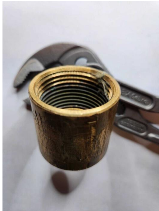
Kuva 2 Hapettumisesta näkyy, että liitos on kiristetty vain kolmelle kierteelle. Pellavaa ollut liikaa ja osa ei päässyt kiertymään alemmas.
