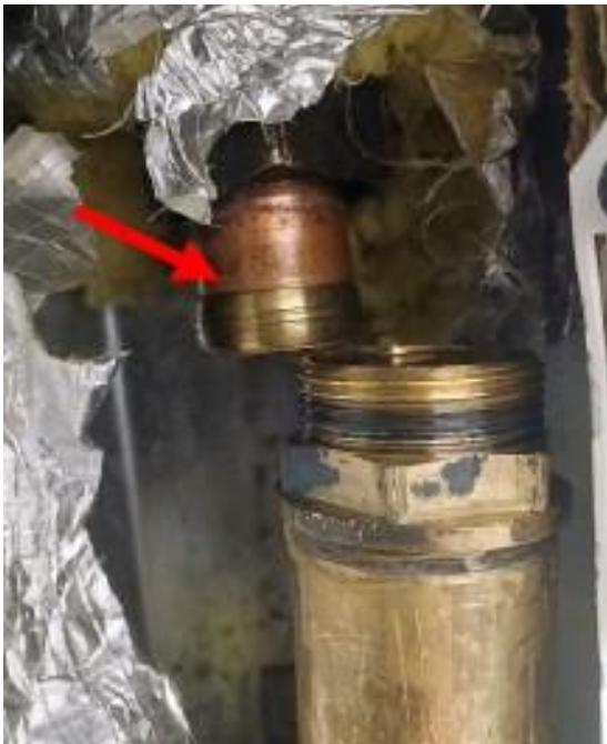
Kuva 1 Myös toinen eli puserrusliitos on ollut huono, liittimen puristusrenkaan jälkeen pitäisi kupariputkea olla näkyvissä n 16,5 mm
