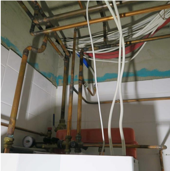
Kuva 1 Kytentäputkisto kuparia, lämmitysputkisto maadoittamaton
