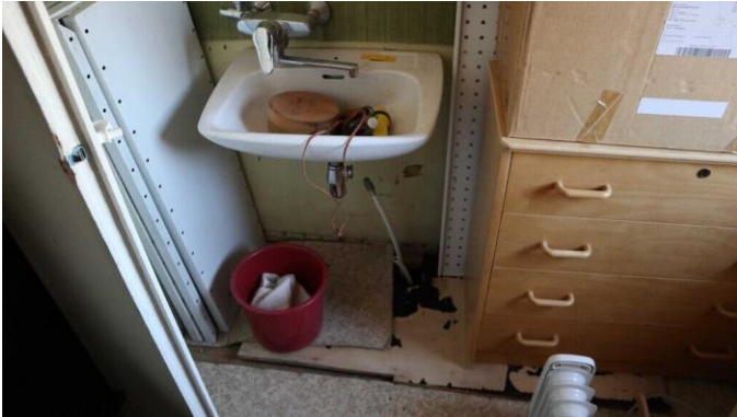
Kuva 2 Jäätynyt putki yläkerrassa
