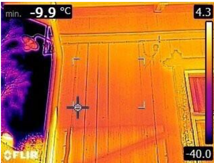
Kuva 4 Sama kohta ulkopuolelta. Rakenne -9,9 astetta
