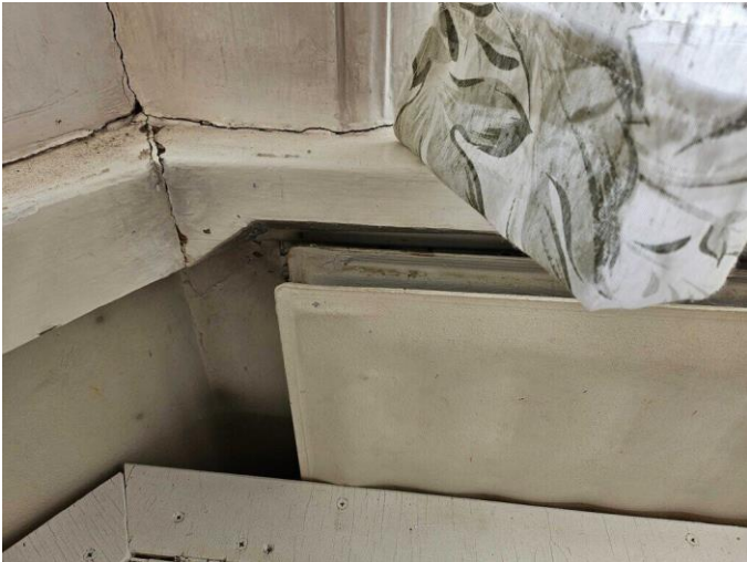
Kuva 10 Konvektoreiden ilmankierto riittämätön osissa kiinteistöä
