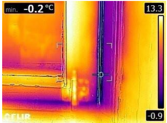
Kuva 7 Ikkunavuodot. Sisäkarmissa -2 astetta.
