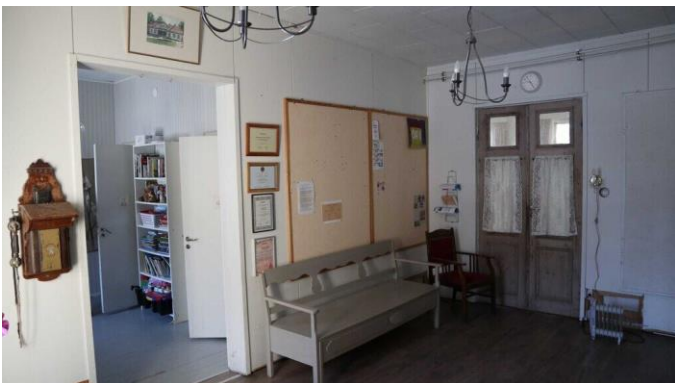
Kuva 12 Ko. huoneessa silmin nähtäviä, jäätymisestä aiheutuneita muodonmuutoksia putkistoissa. Putkistot laajenneet 2-3 mm . Välikerroksena oleva alumiinikalvo revennyt.
