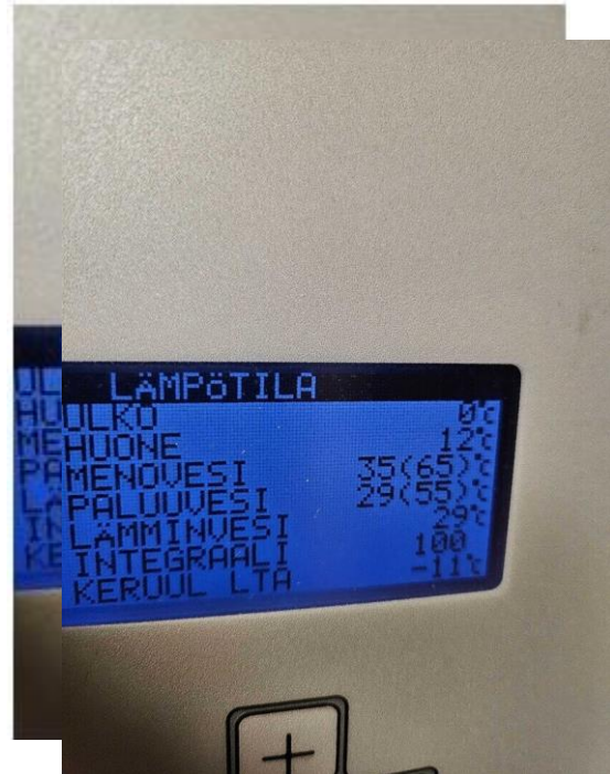
Kuva 11 Keruupiirissä ilmaa. Keruupiirin lämpötilat väärät. Kierto ei toimi
